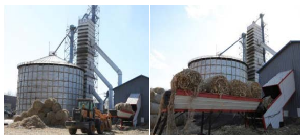
图 3-13 秸秆打捆直燃锅炉
