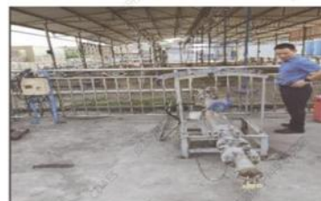
✓ 液态VOCs物料卸装管道
