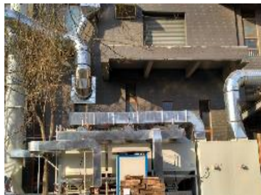
治理设施-活性炭吸附-脱附- 催化燃烧装置
