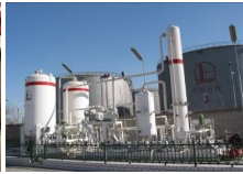
储油库处理装置
